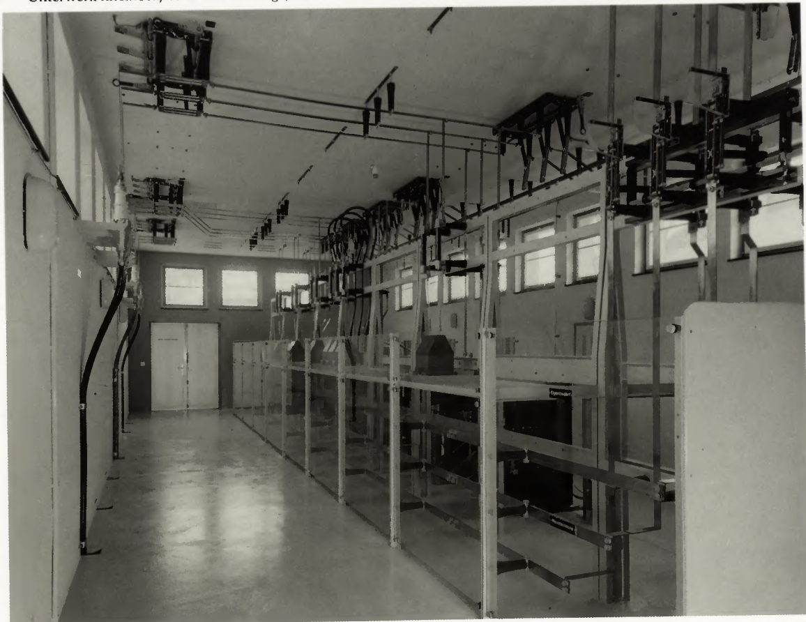
Unterwerk Rheineck, 10-kV-Schaltanlage, 1959–1989
