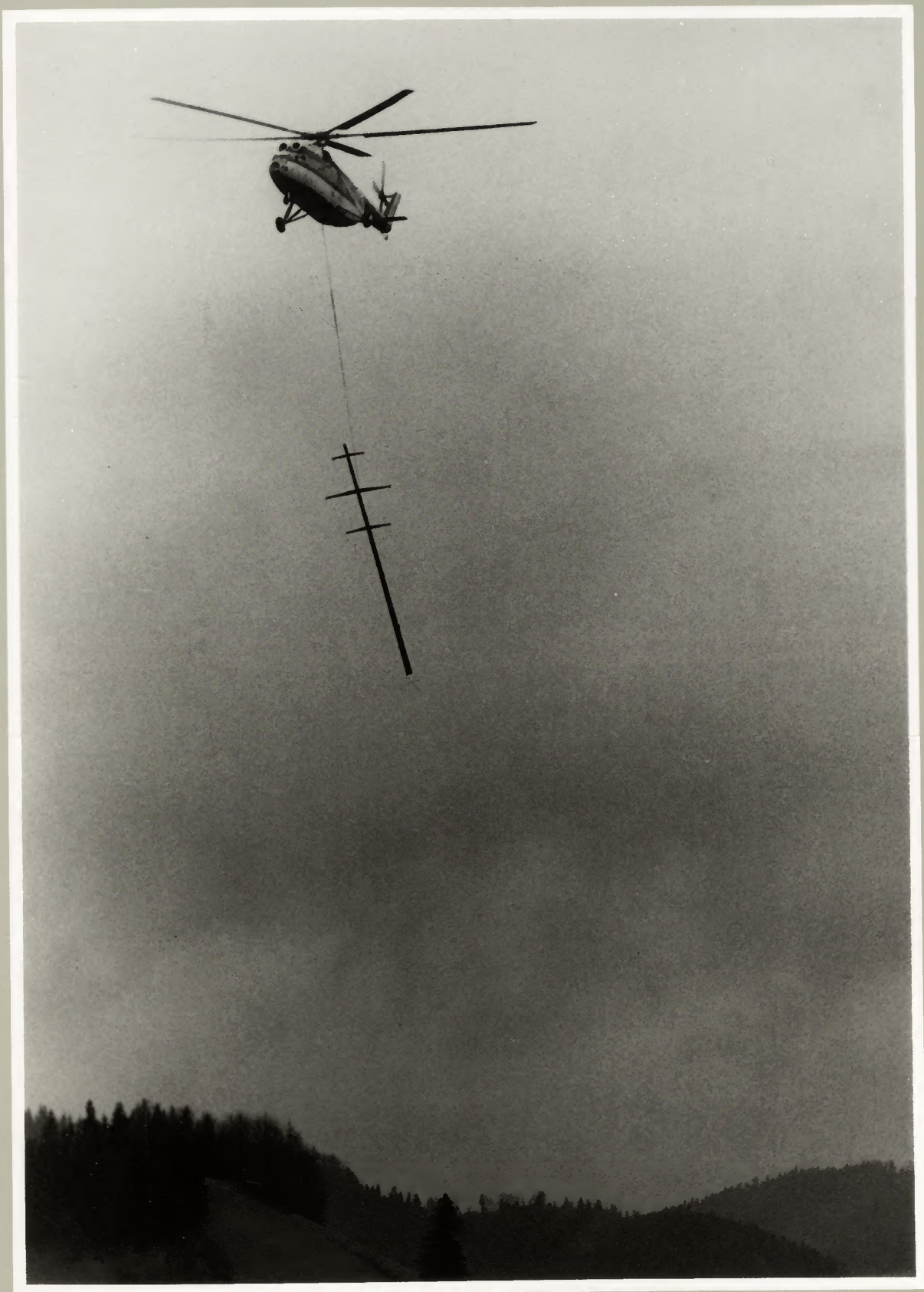
Hochspannungsleitung Herisau-Schwellbrunn, Erstellung 1966
