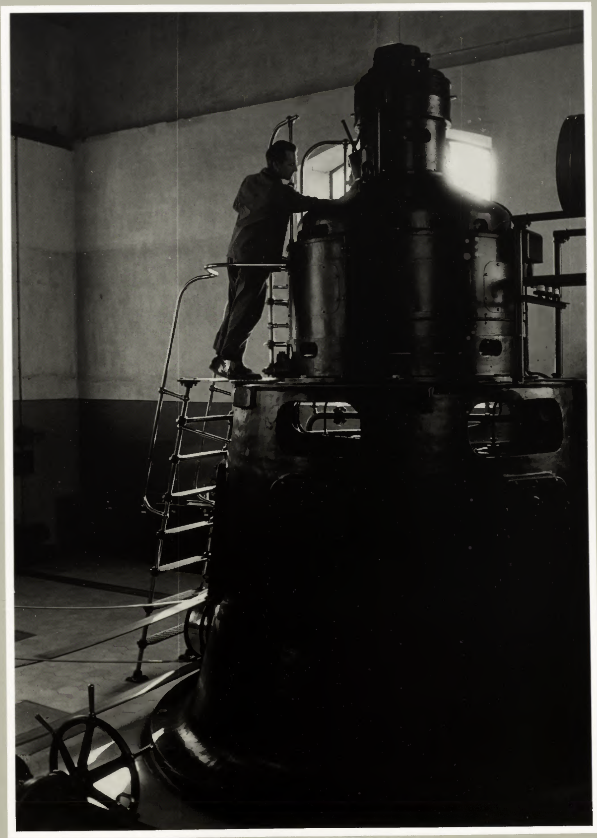
Binnenkanalwerke, Maschinengruppe, in Betrieb 1927–1988
